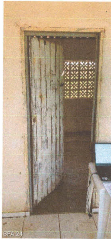
PORTAS EM PÉSSIMO ESTADO
